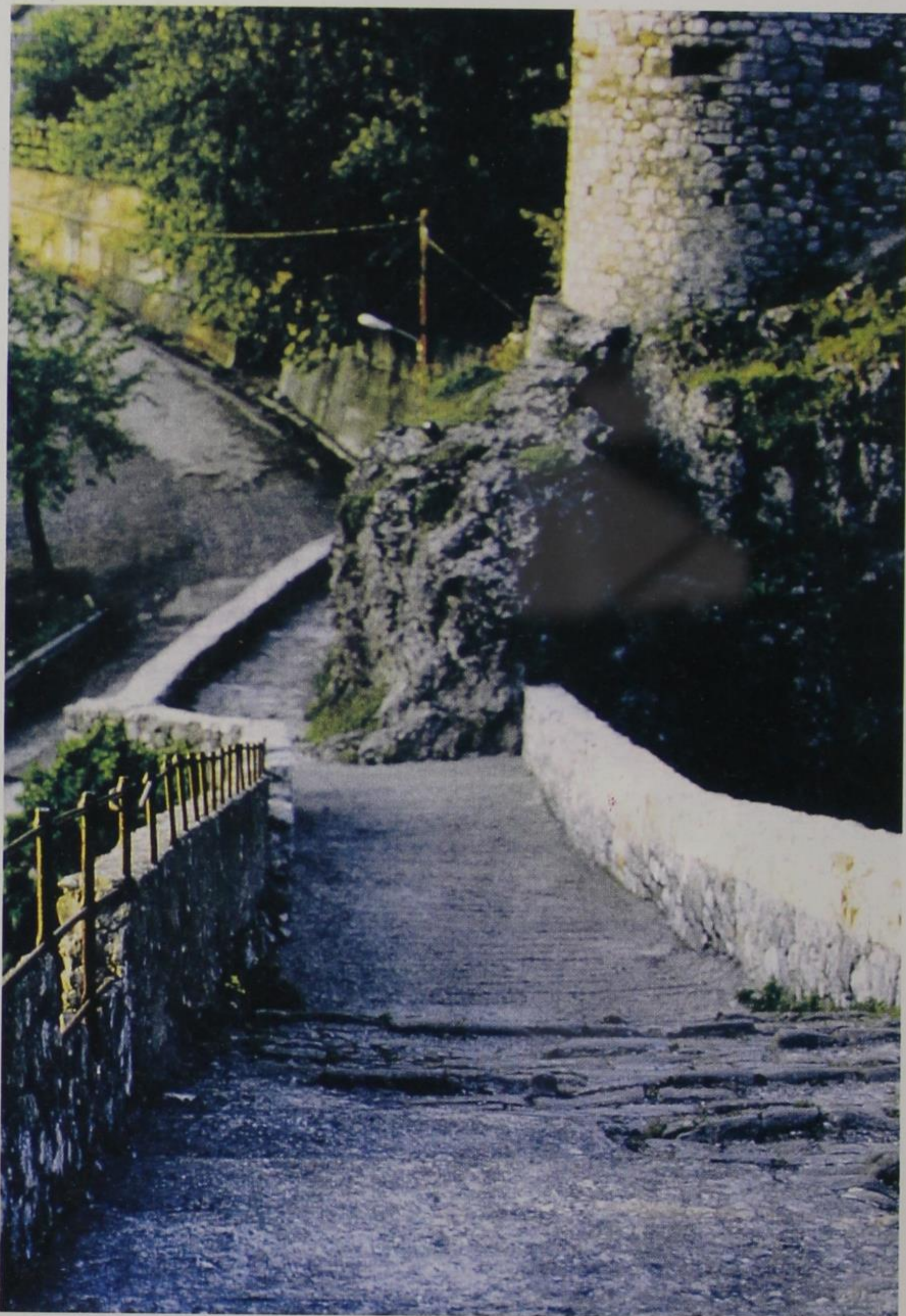
Εικ. 33. Αώος/Κόνιτσα. Η σημερινή κατάσταση του βορεινού άκρου της παλιάς πέτρινης γέφυρας. Διακρίνεται η επέμβαση και ο νεωτερικός πυργίσκος (1995).
