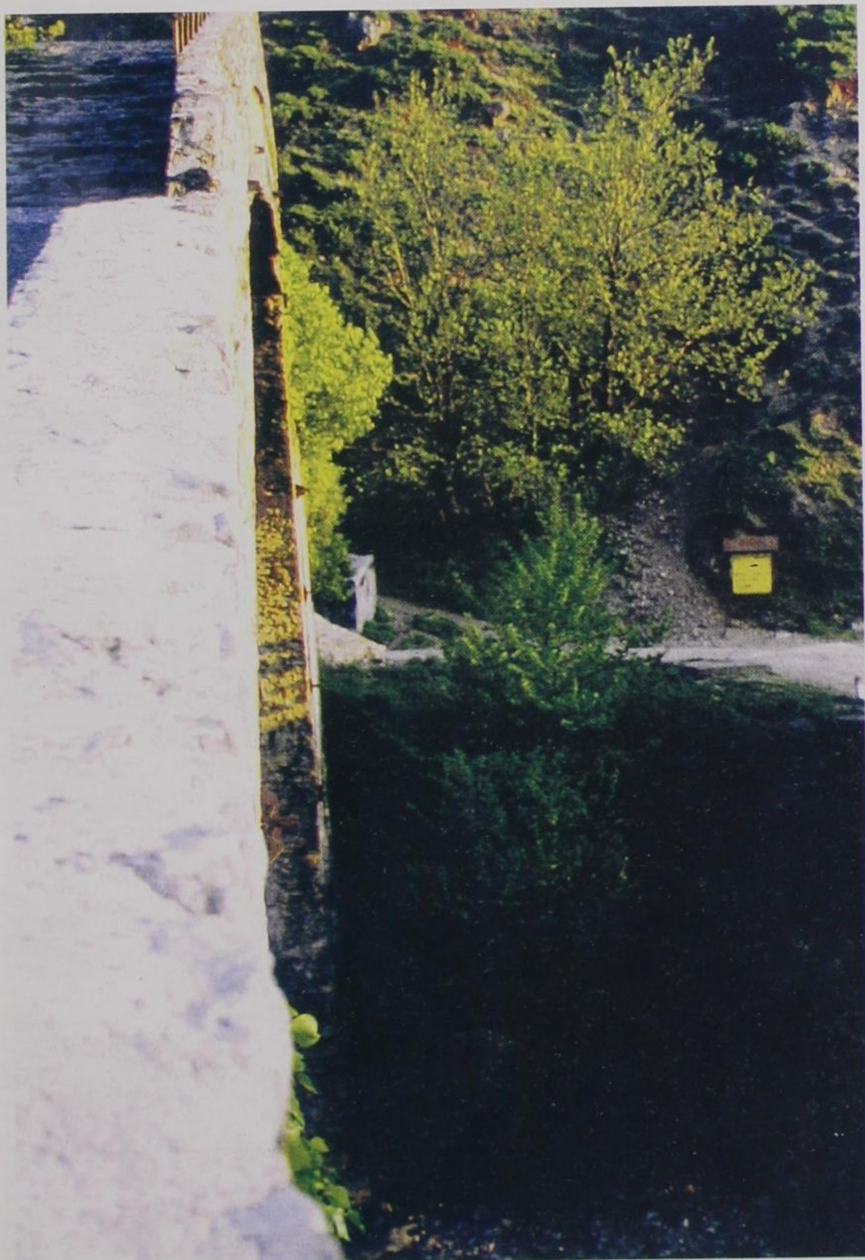
Εικ. 30. Αώος. Γέφυρα Κόνιτσας. Η προς τα κατάντη (δυτική) πλευρά, φωτογραφημένη από το βορεινό (δεξιό) ποδαρικό, σχεδόν κατ' ευθυγραμμία με το απέναντι (1995).
