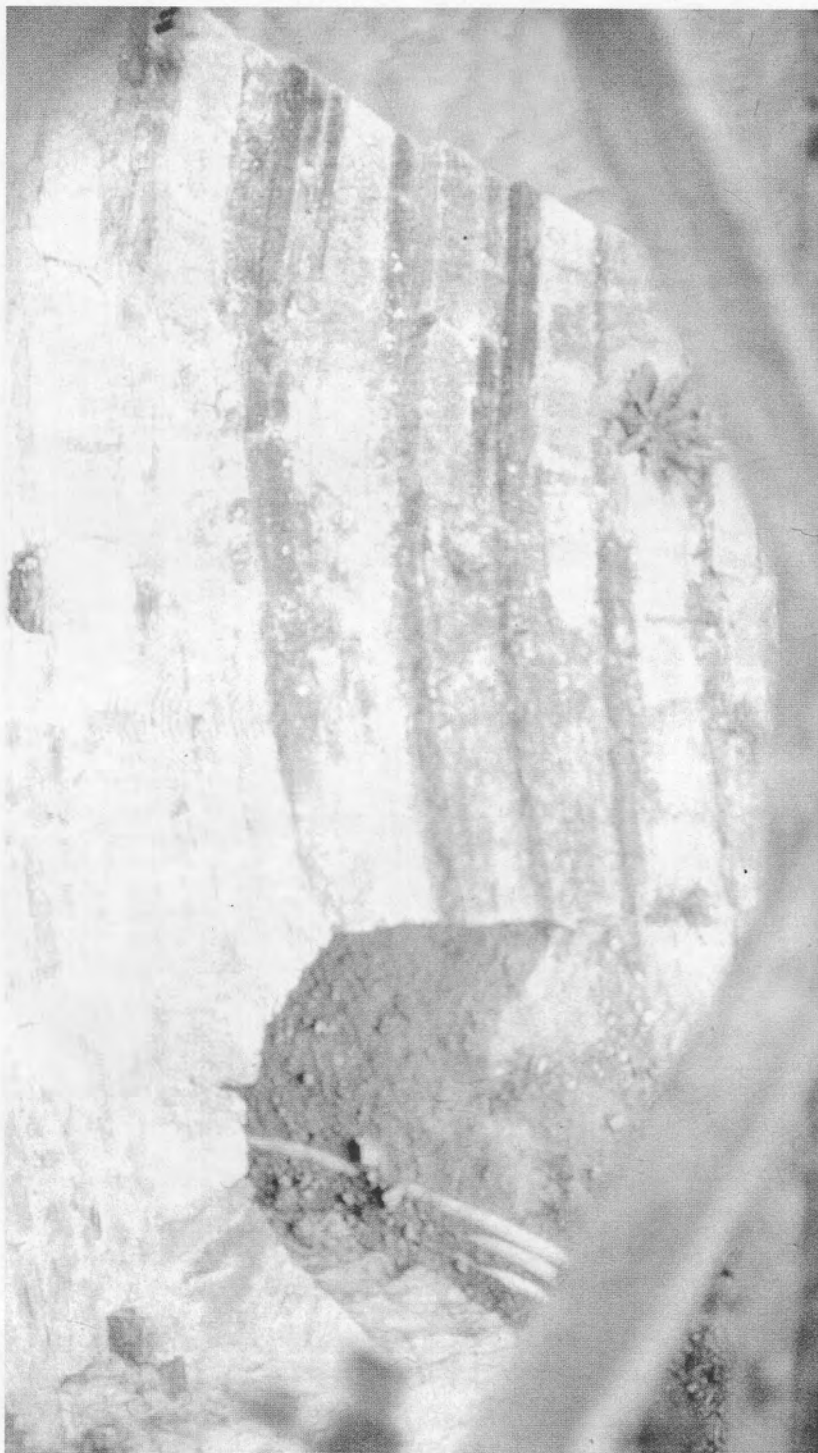
Εικ. 28Α. Αώος, Γέφυρα Κόνιτσας. Δεξιό ποδαρικό. Όψη από τα κατόντη. Φαίνεται η έξοδος της καμάρας για το νεραύλακο (1995).
