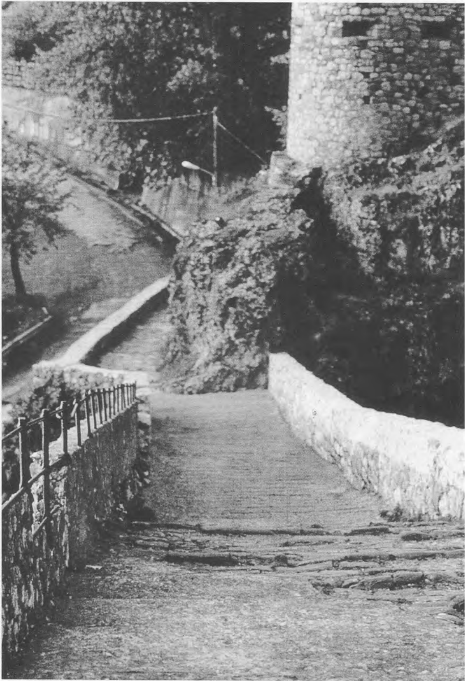
Εικ. 33. Αώος/Κόνιτσα. Η σημερινή κατάσταση του βορεινού άκρου της παλιάς πέτρινης γέφυρας. Διακρίνεται η επέμβαση και ο νεωτερικός πυργίσκος (1995).
