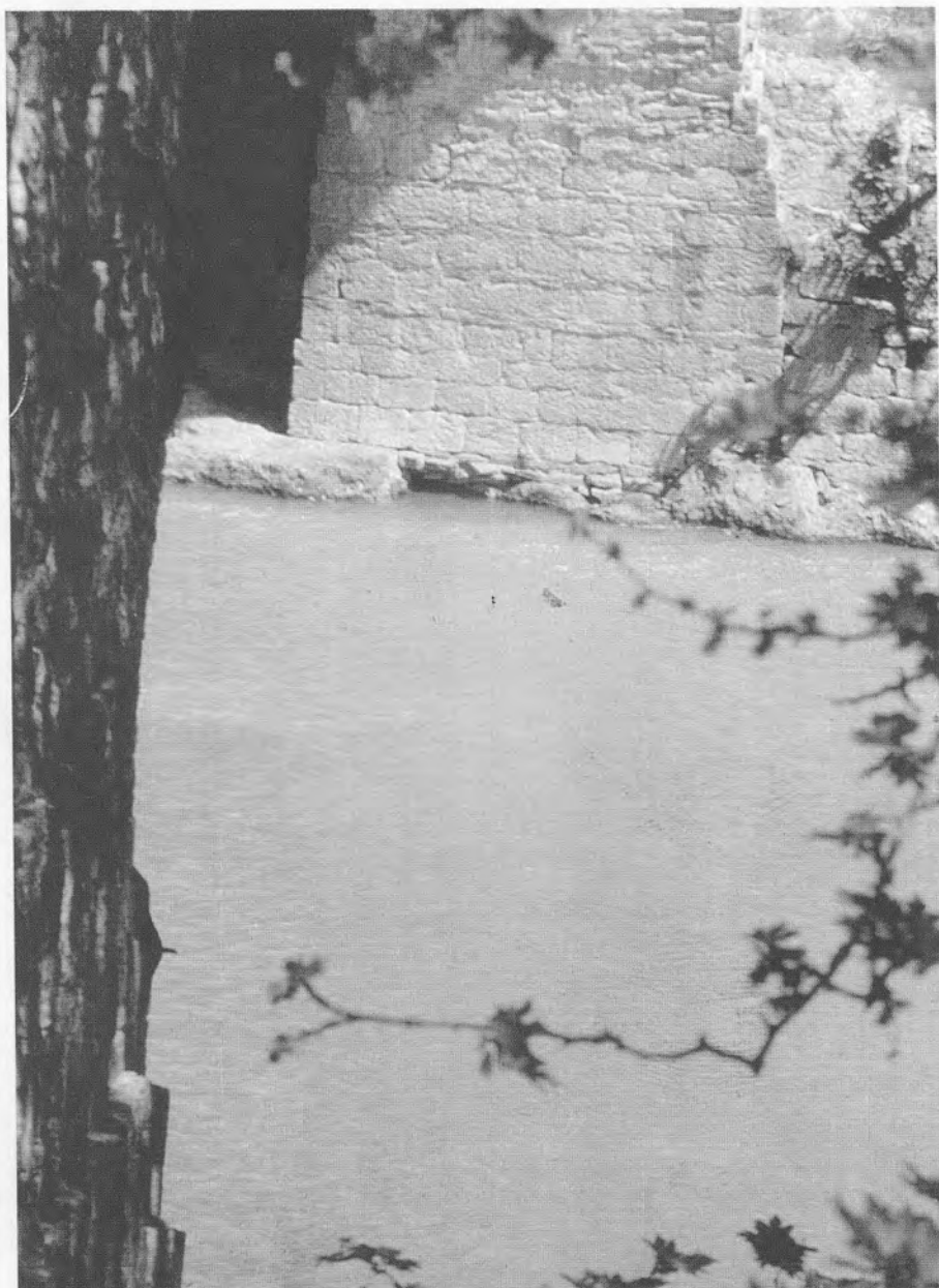
Εικ. 27. Αώος. Γέφυρα Κόνιτσας. Όψη της στενής (εσωτερικής προς τον ποταμό) πλευράς του δεξιού (= βορεινού) ποδαρικού. Διακρίνεται η στιβαρή δόμηση της βάσης με επτά δόμους καλολαξευμένων μεγάλων λίθων, και η προς τα πάνω βαθμιαία μείωση με αναβαθμιδώσεις («πατούρες»). Τέσσερες απ' αυτές διακρίνονται και στο από 'δω (αριστερό) ποδαρικό (1995).
