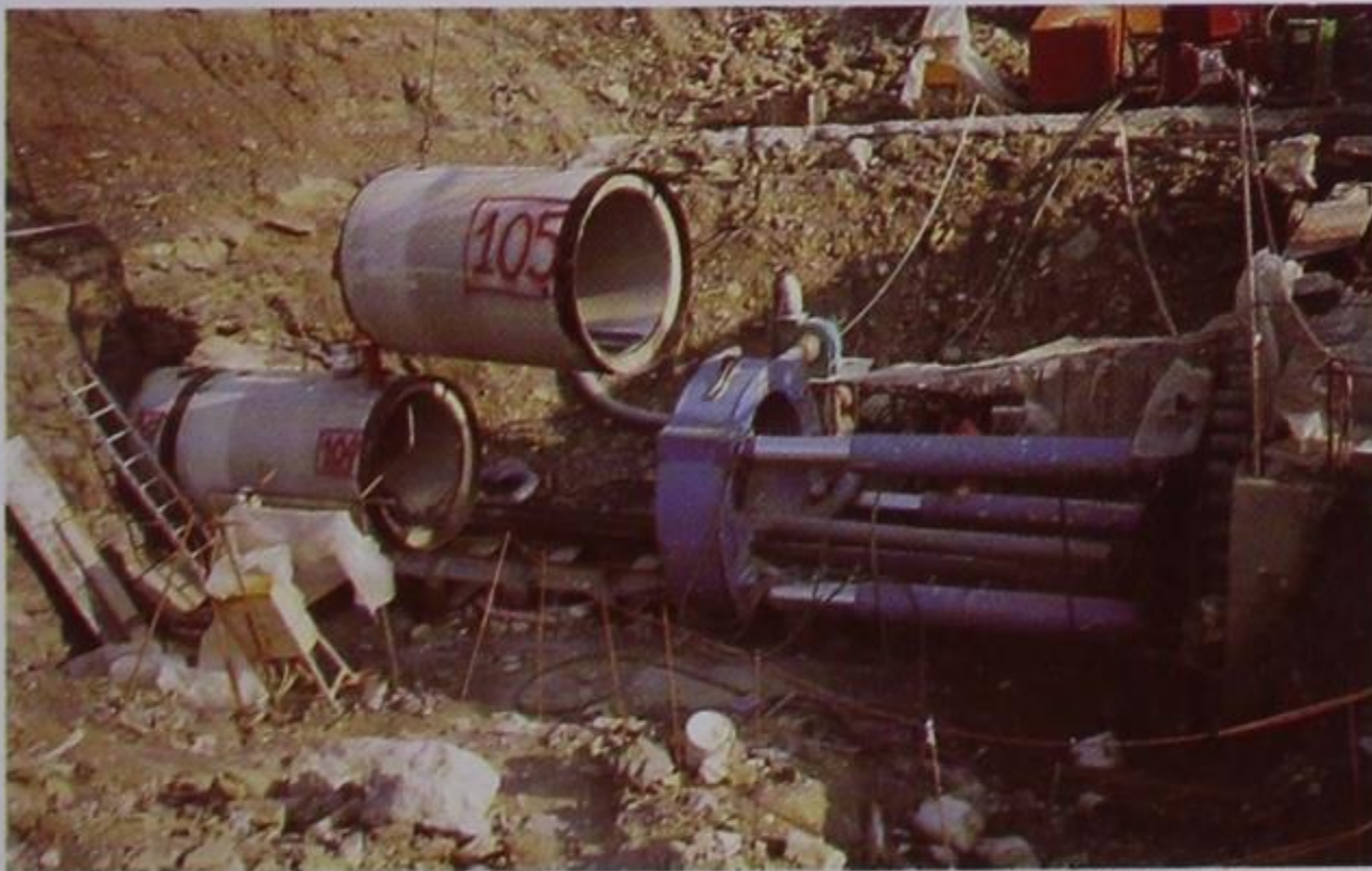
Η είσοδος της γαλαρίας απ' όπου γινόταν η υδραυλική προώθηση των σωλήνων. Εδώ, το κατέβασμα της 105ης σωλήνας.
