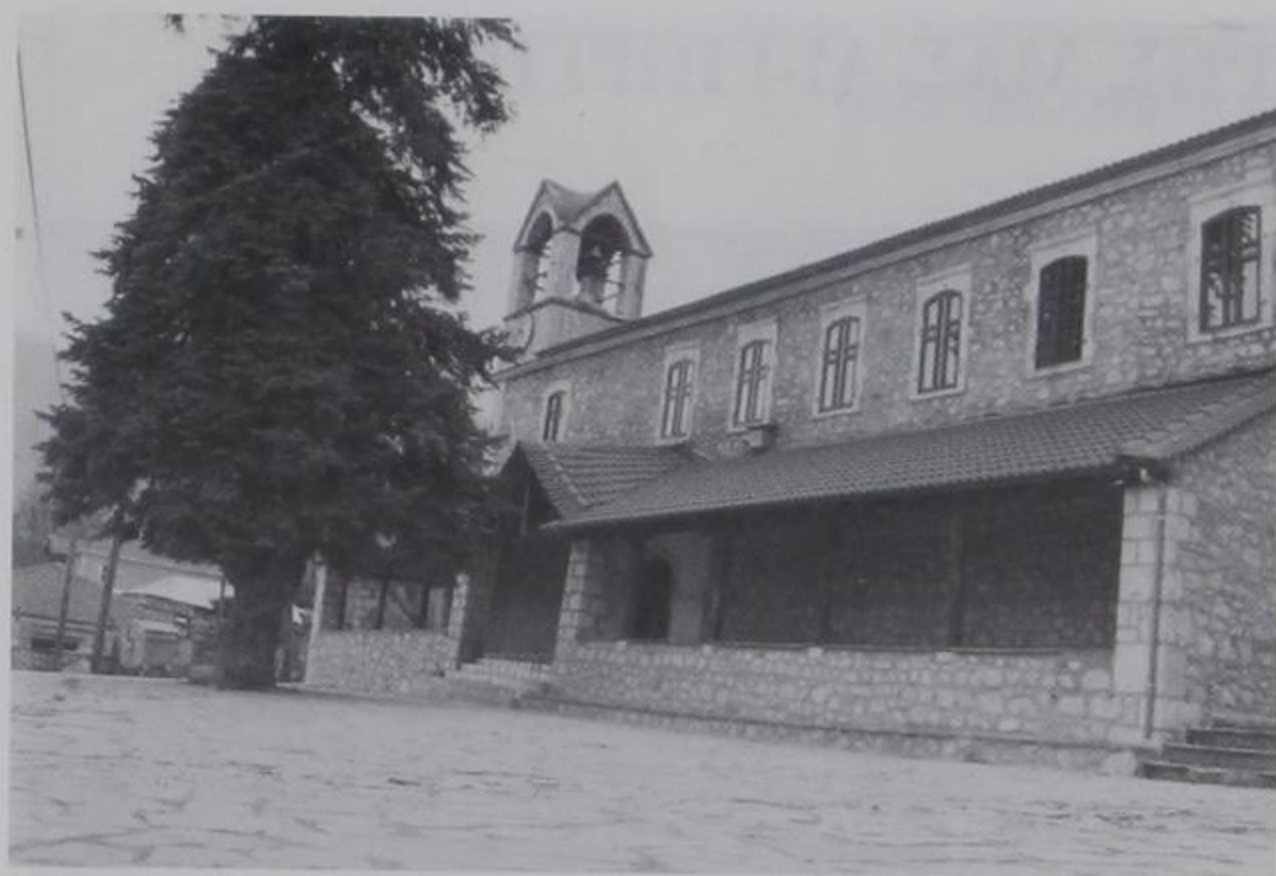
Ο Ι. Ναός του Αγίου Γεωργίου μετά την σωτήρια και καλαίσθητη εξωτερική επισκευή του.
