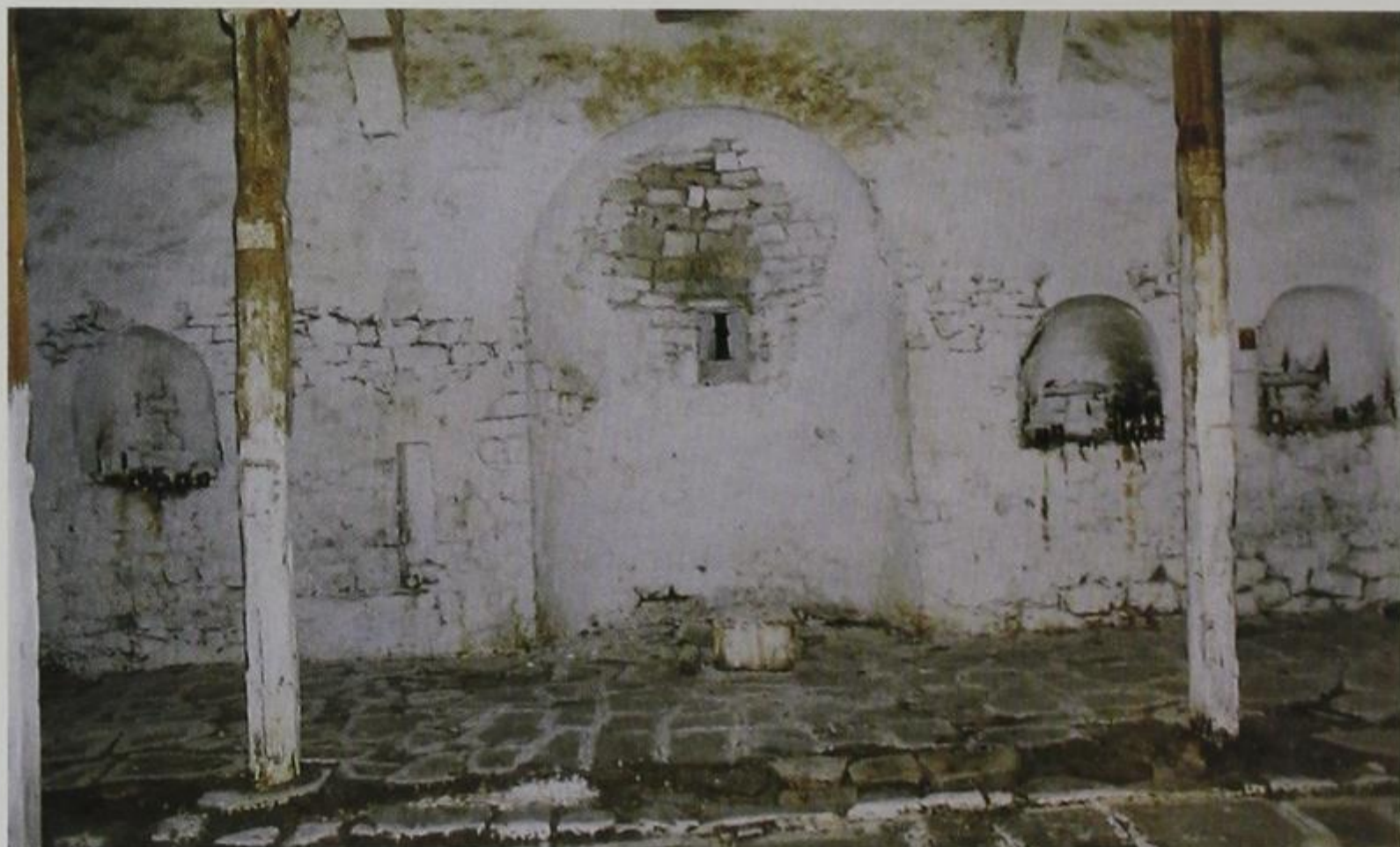
Το εσωτερικό της Μεταμορφώσεως του Σωτήρος μόνο εκκλησία δεν θυμίζει... Από την Αγία Τράπεζα έχει απομείνει μόνο μια μικρή βάση!
