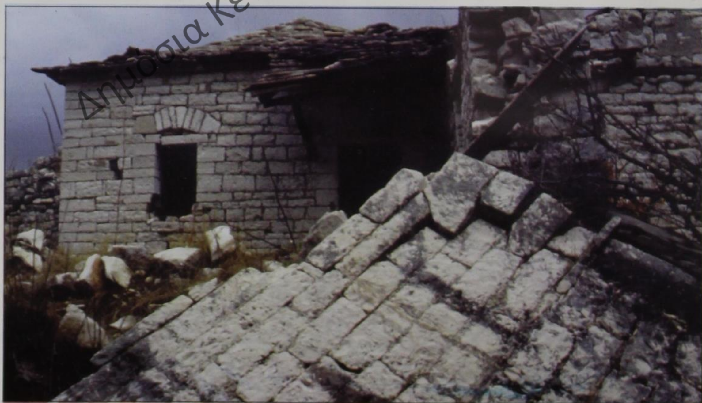
161. Ζερβάτι Δρόπολης, Πλατοβούνι. Μονή Ντρεάνου, χαλάσματα των εγκαταστάσεών της (χαρακτηριστικό στερεότητας της τοιχοποιίας είναι το μονοκόμματο γκρέμισμα του τοίχου).
