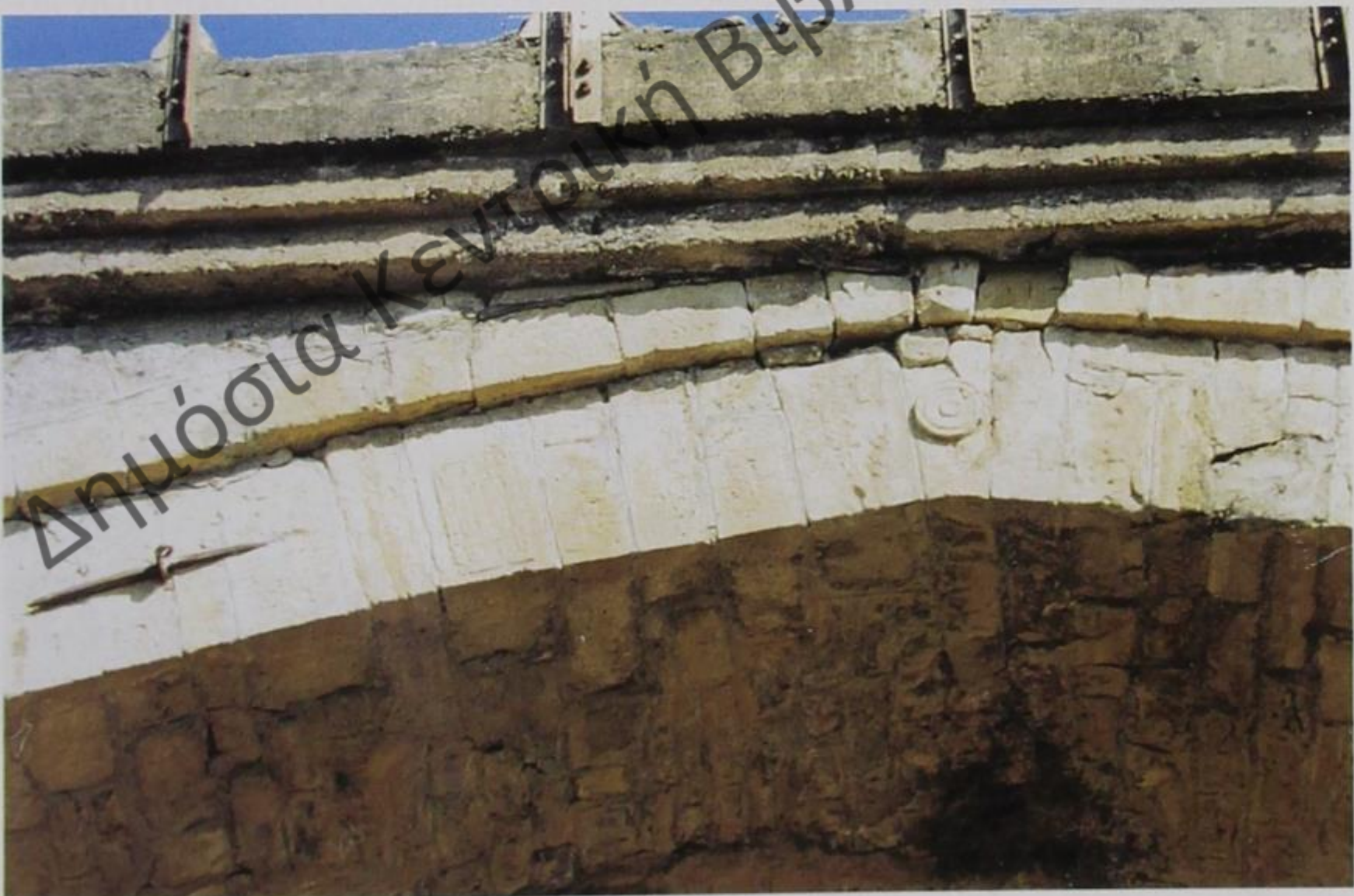
Εικ. 78Α. «Γεφύρι του Πασιά» στον Ενιπέα Φαρσάλων. Όψη από ανάντη πρώτου τόξου από αριστερή όχθη. Στο «κλειδί» διακοσμητικός ομφαλός, αριστερά «άρπεζα», δεξιά της στον δ' λίθο ορθογώνιο γεωμετρικό γραμμικό σχέδιο (Φωτ. 07.08.2000, Α.Π.: Φ.00.VII/τ. αριθ. 35Α).
