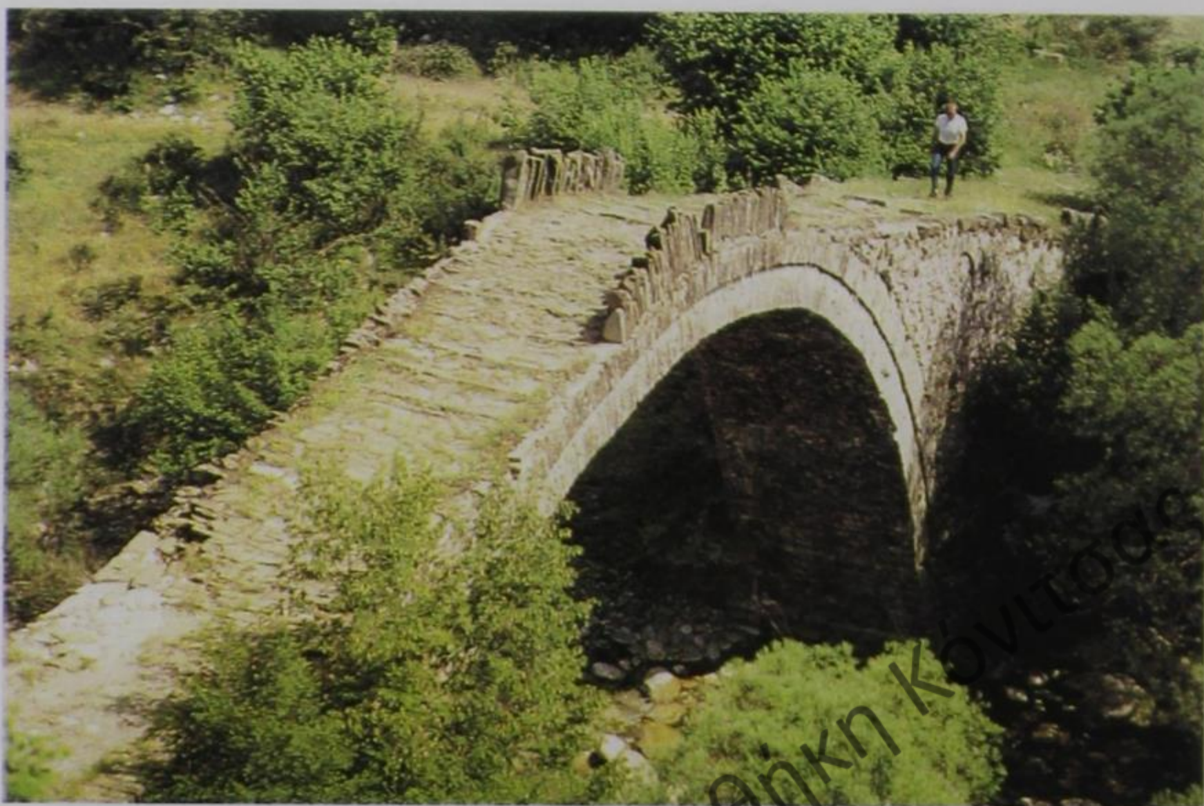
Εικ. 81. Το Γεφύρι του Χάτσιου στο Βικάκι, κάτω από το Τσεπέλοβο στο Ζαγόρι. 1804. (Χορηγός Λάμπρος Χάτσιος). Οι «αρκάδες» συμπυκνώνονται και δημιουργούν στηθαίο στη ράχη μόνο της καμάρας (φωτ. Σπ. Ι. Μαντάς, Ηπειρωτικά Γεφύρια , 1984, σ. 99, πικ. 54).
