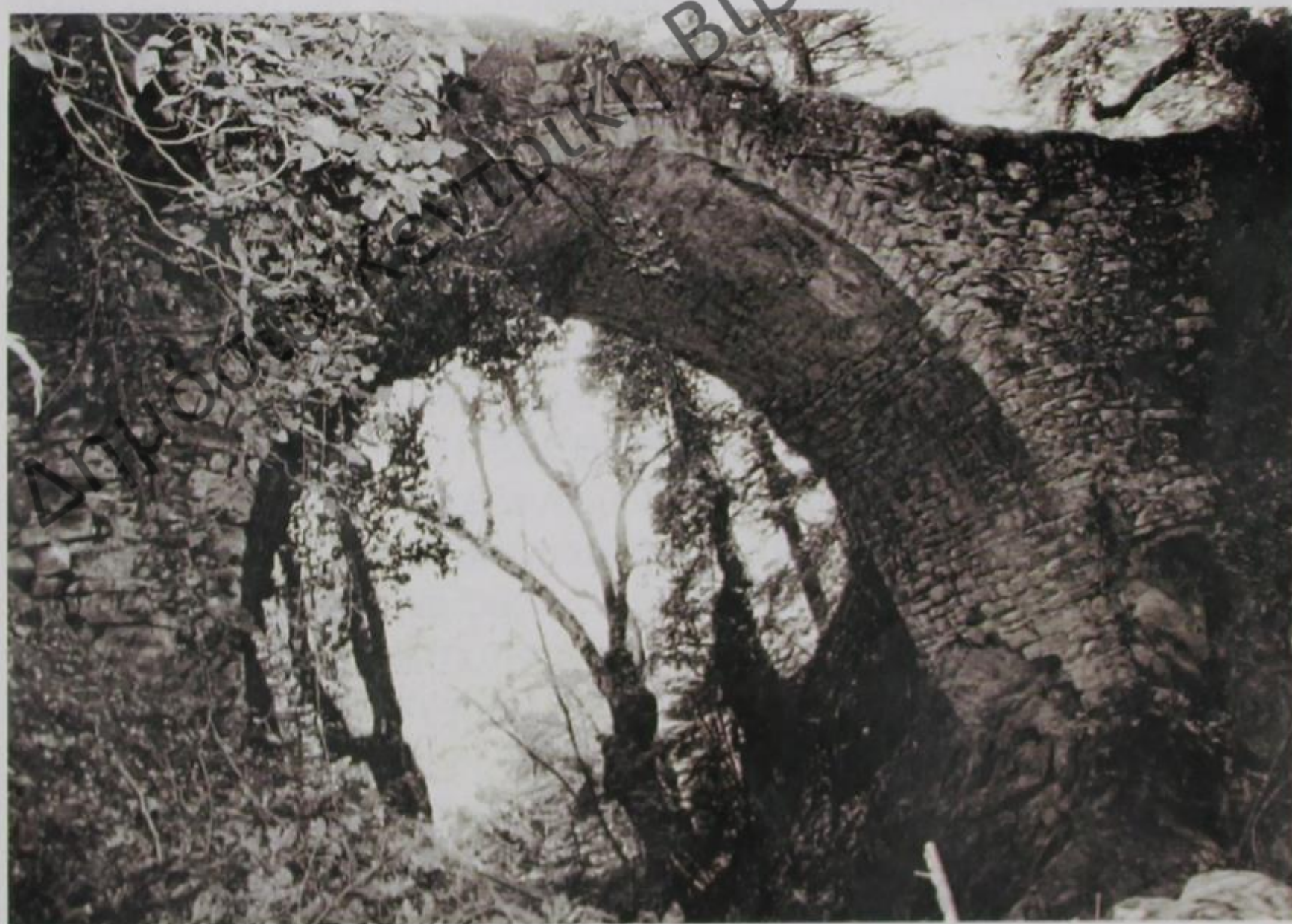
Εικ. 94. Γέφυρα «Καμάρα» στο ρέμα Μουτζουράκι, όπου το παλαιό επώνυμο χωριό, κοντά στον οικισμό Τυμφρηστού (στην Πέρα Κάψη) Φθιώτιδας. (Φωτ. Περικλή Φύκα, Λαμία/Λειανοκλάδι).
