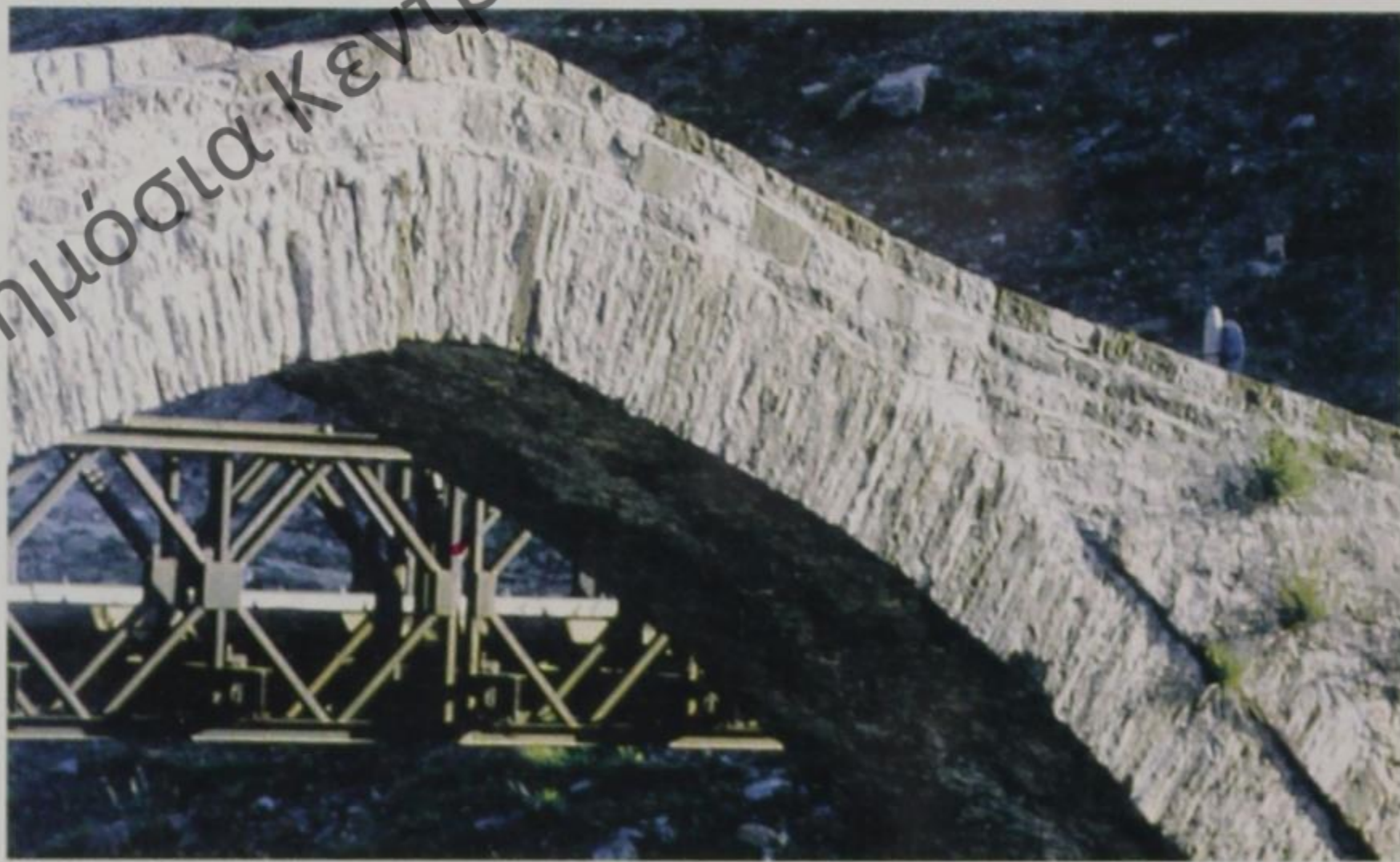
Εικ. 10. Σαραντάπορος. Γεφύρι της Ζέρομας, είτε Καντζιώτικο Γεφύρι. Κορυφαίο τμήμα μεγάλης καμάρας. Όψη από τα ανάντη (1995).
