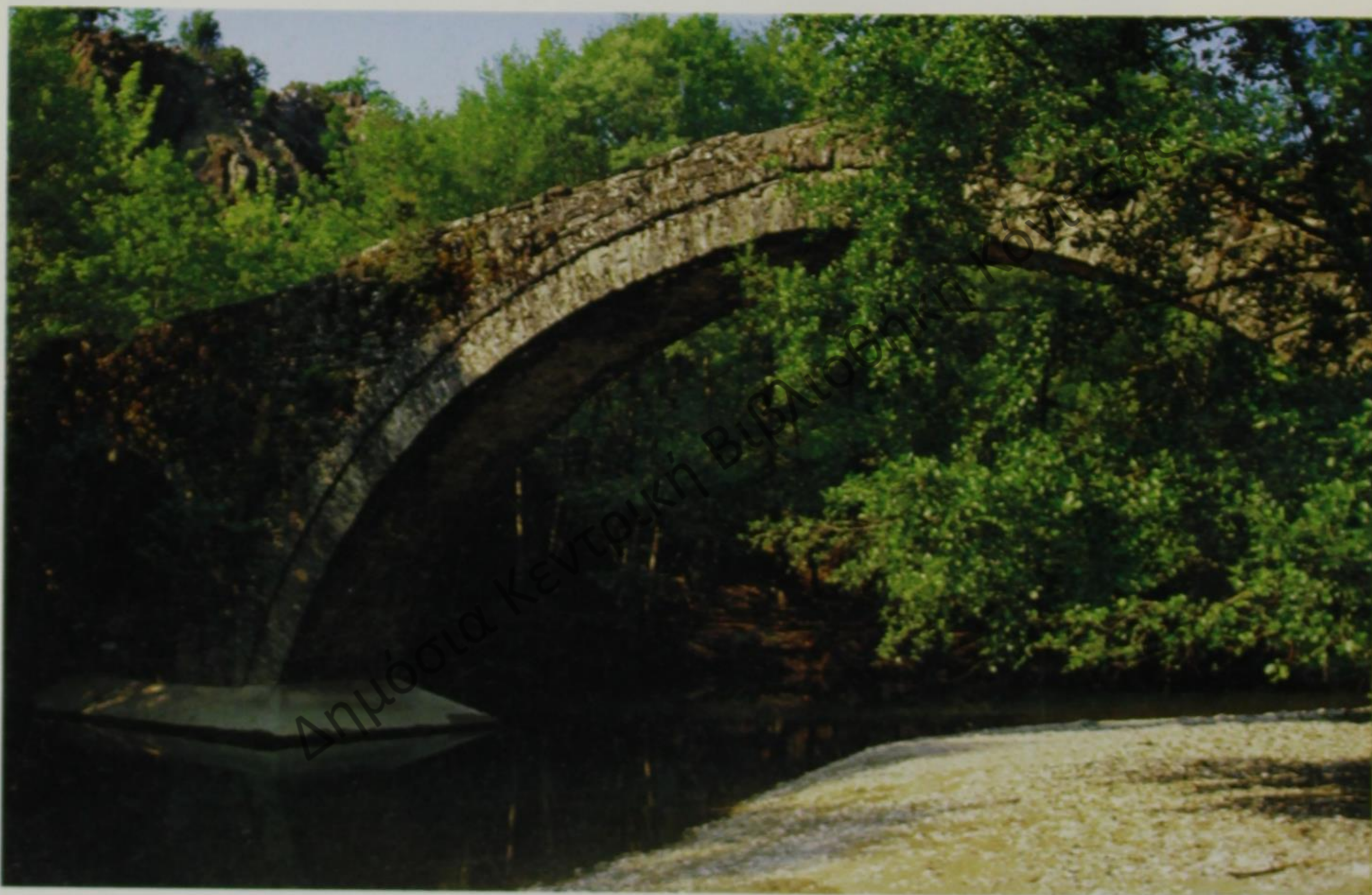
57. Το γεφύρι του Καμπέραγα, στο Ζαγοραϊκό ποτάμι, αποφεύγοντας την επίδειξη σε ύψος και προκιδόντας τούτο το «συγκράτημα» στα άκρα του, πέτυχε να διαμορφώσει μία παράξενη μορφή που δεν μοιάζει με καμία άλλη.
