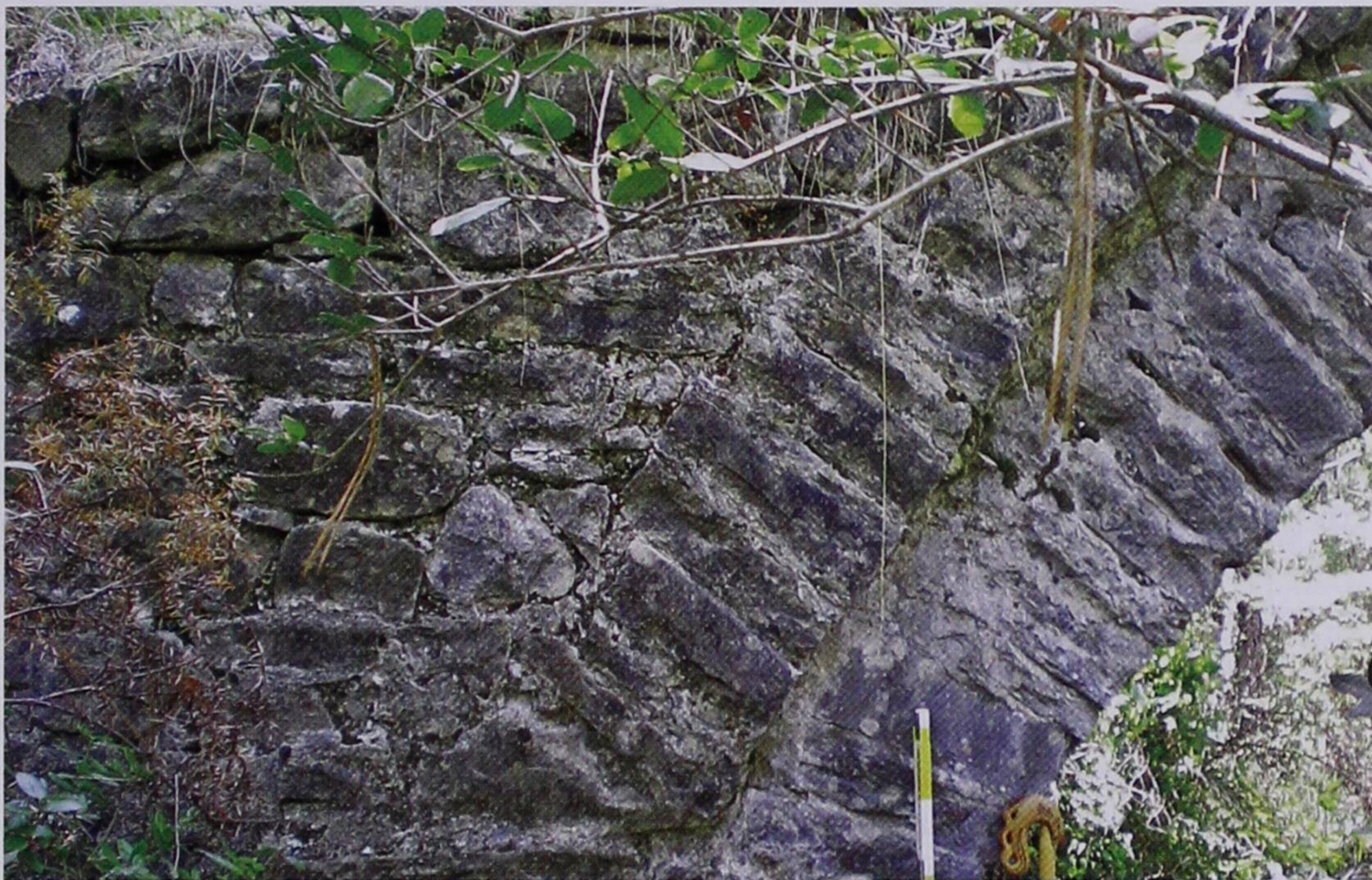
(Φωτ. 2-4): Αύγουστος 2011. Λεπτομέρεια κύριου και βοηθητικού τόξου «γέφυρας Όρλας». [Πηγή: Προσφορά Παναγιώτη Δήσιου, εξ Αγίας Βαρβάρας].
