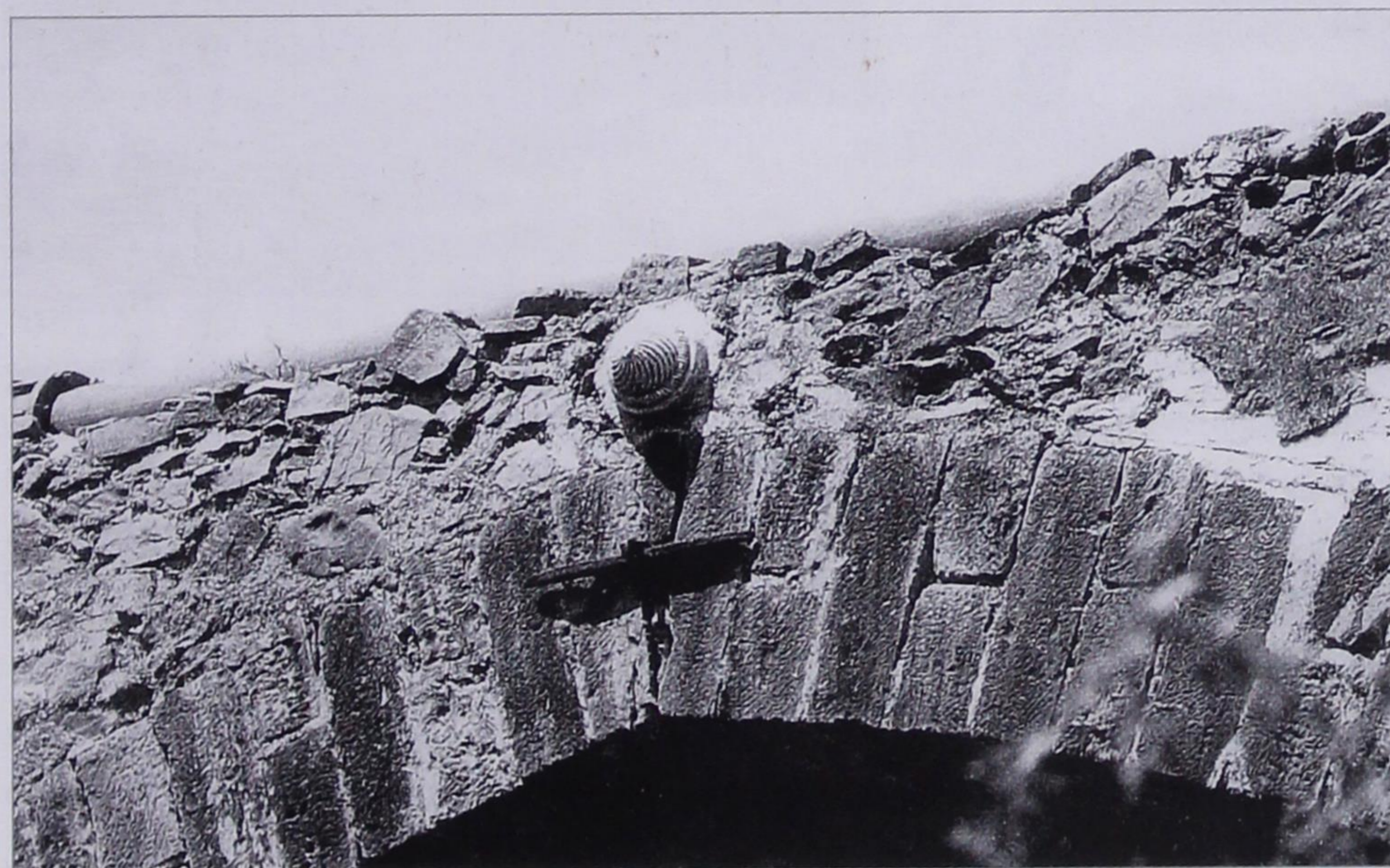
Εικ. 78, Β (= επάνω) & Γ. Υδραγωγείο Χίου «της Κόρης το Γεφύρι». Έργο αρχικά 15ου-16ου αι. – Β = Απεικόνιση τμήματός του. – Γ = Λεπτομέρεια κορυφής αριστερού τόξου εικ. 78Β με «άρπεζα» και διακοσμητικό ομφαλό από μετασκευή περιόδου Τουρκοκρατίας [άραγε αρχών 19ου αι.:] (:Μανώλης Μ. Βουρνούς, «της Κόρης το Γεφύρι» (1997), σ. 336/7 εικ. 1 & 3. Βλ. πλήρη τίτλο σημ. 154).
