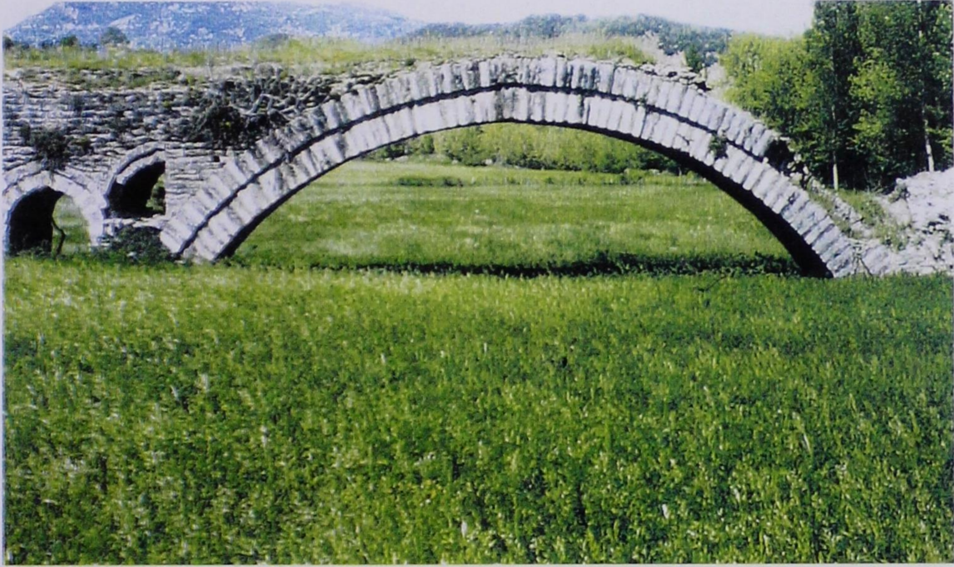
Εικ. 22. Η εγκαταλειμμένη, από τους ανθρώπους και το ποτάμι της Άραχθο «γέφυρα της Κυράς» κοντά στη Μπαλντούμα Ηπείρου, έργο του 1762. Όψη από τα κατάντη (Φωτ. 10.5.1995, Α.Π.).
