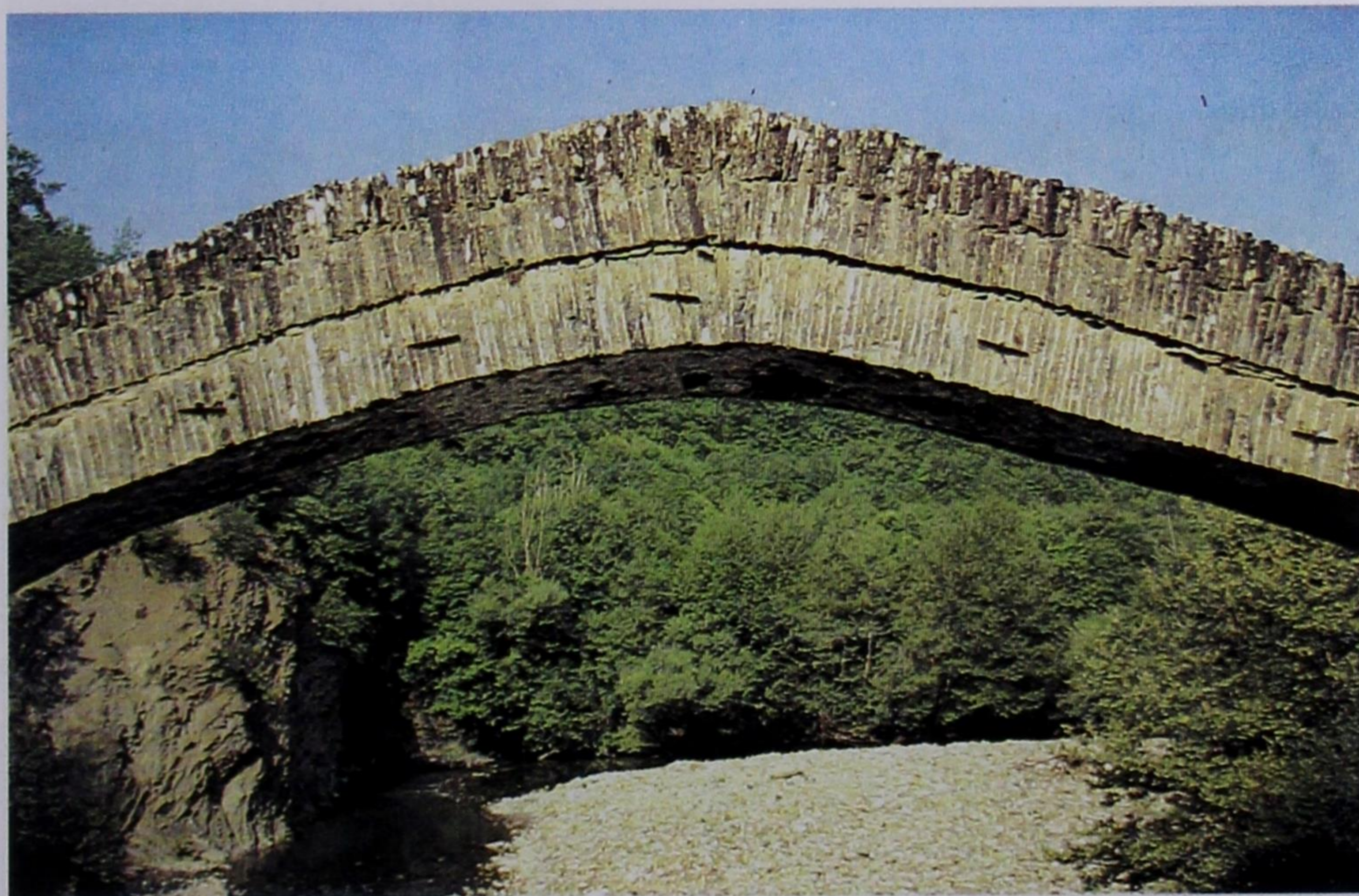
Εικ. 68Α και Β. «Γεφύρι της Τσίπιανης» στο ποτάμι Βάρδα κοντά στο χωριό Γρεβενήτι στο Ζαγόρι, έργο 1875. – Α' (επάνω): Σύνολο· διακρίνεται η σειρά από «άρπιζες» στο τόξο και το πλήρες στηθαίο. - Β' Λεπτομέρεια του μέσου του τόξου που διατηρεί την ισλαμίζουσα οξυκόρυφη μορφή, παρουσιάζει αξονική «άρπιζα» και δείχνει τη δομή του στηθαίου (: Φωτ. Σπ. Ι. Μαντάς, 1984, Α' = σ. 103 εικ. 58, Β' = σ. 104 εικ. 59).
