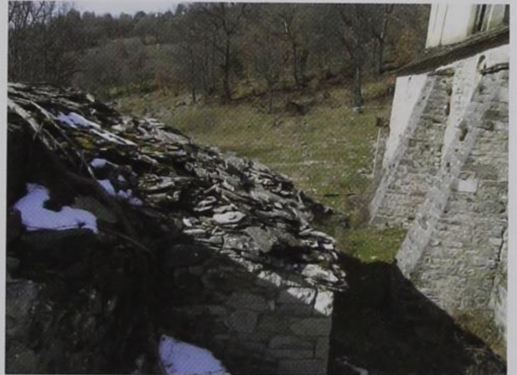
Λεπτομέρεια κατεστραμμένης στέγης της κεντρικής πύλης.
